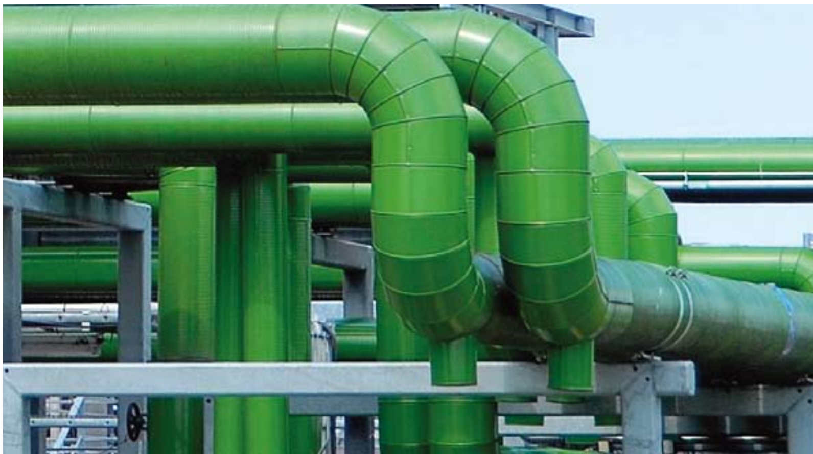
Vapor conducido por tuberías desde una central eléctrica e instalación de transformación de etanol para su reutilización en el polo de simbiosis industrial de Kalundborg en Dinamarca.
