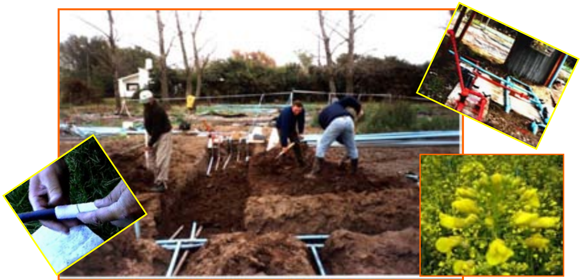
Figura 6. Sistema de riego subterráneo y su protección. UNRC. Río Cuarto. Córdoba.
