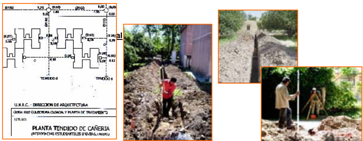
Figura 1. Trabajos previos de interconexión de la red cloacal. UNRC. Río Cuarto. Córdoba
